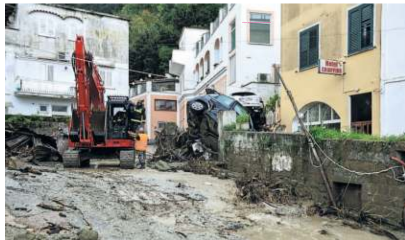
▲ I primi interventi dopo la frana a Casamicciola
